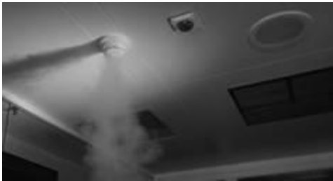
Bild 2: Lecksuche seitens des STZ EURO mittels Nebel auf der Baustelle an einem fehlerhaft installierten Rauchmelder.
